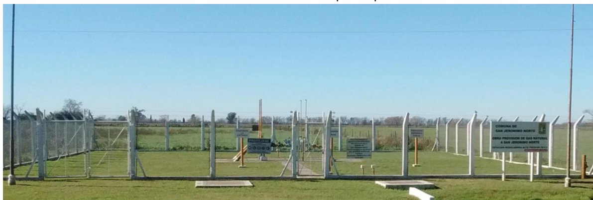
Equipamiento de Gas. Fuente: San Jerónimo Norte Gas
