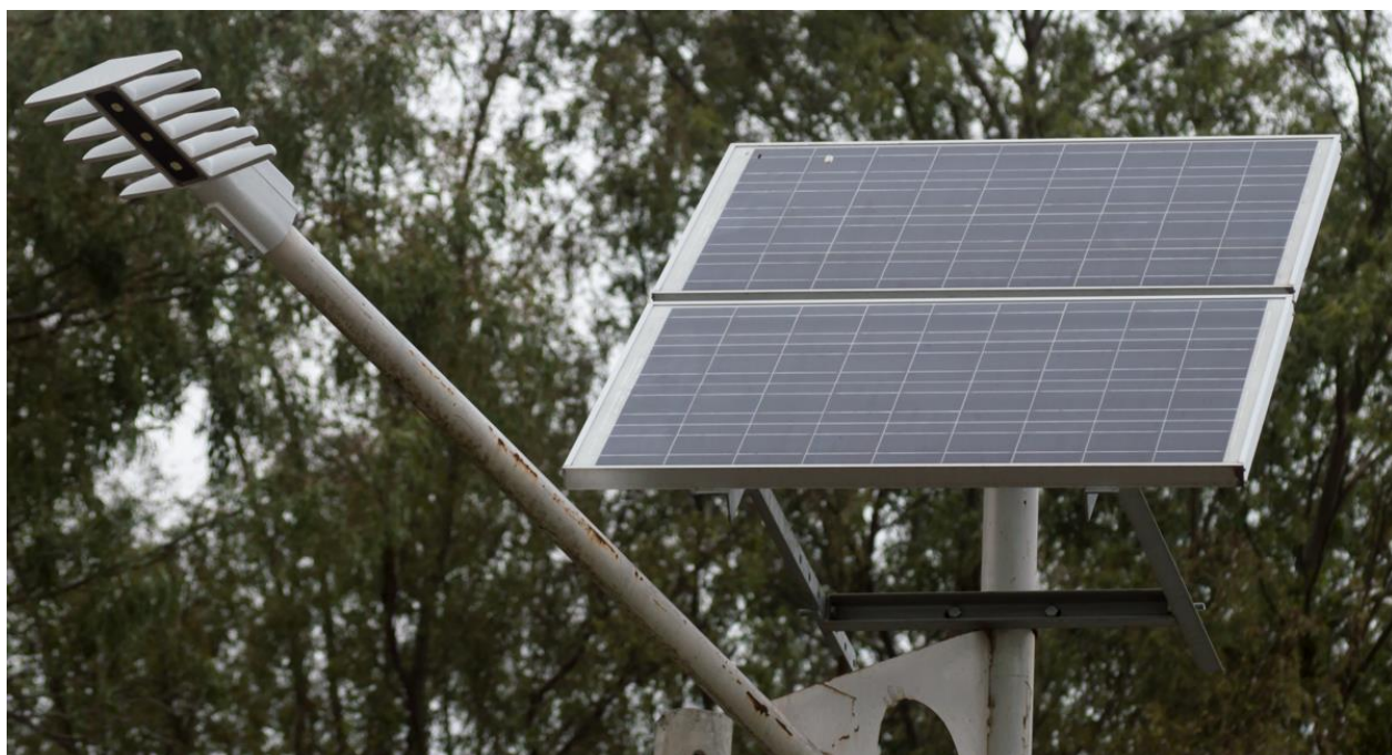
Sistema de iluminación pública del “Barrio Solar” – Fuente: Comuna de San Carlos Sud
