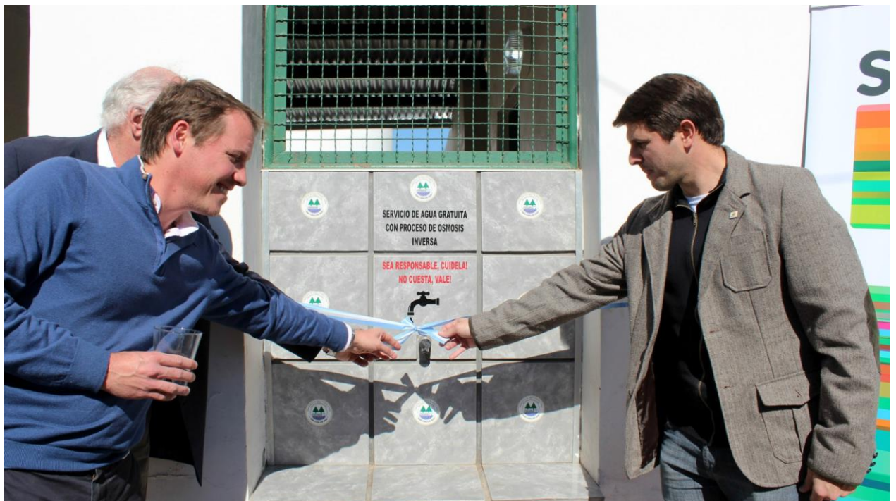
Planta de osmosis inversa de San Carlos Sud – Foto: Gobierno de la Provincia de Santa Fe
