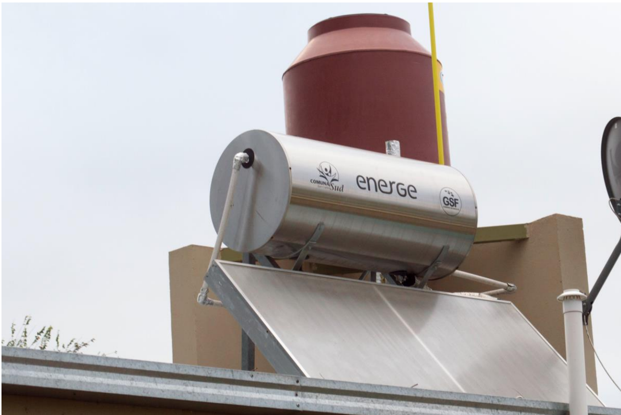
Calefones solares del “Barrio Solar” – Fuente: Comuna de San Carlos Sud
