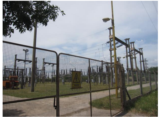
Planta transformadora de la EPE
