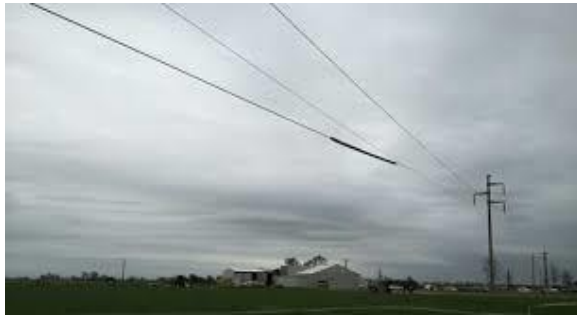
Línea de Alta Tensión Arrufó – San Guillermo FUENTE: Sinmordaza.com
