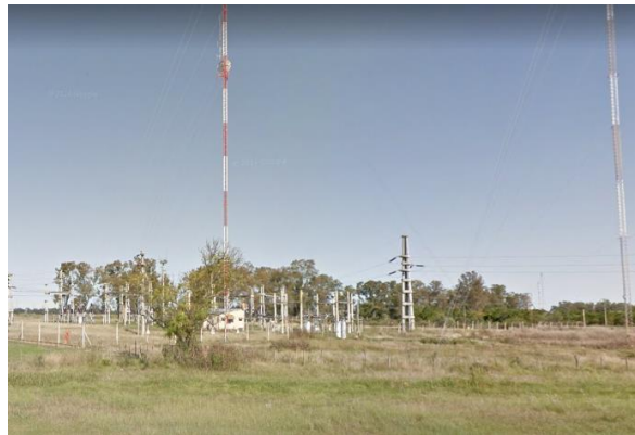
ESTACIÓN TRANSFORMADORA ELECTRICA EPE
