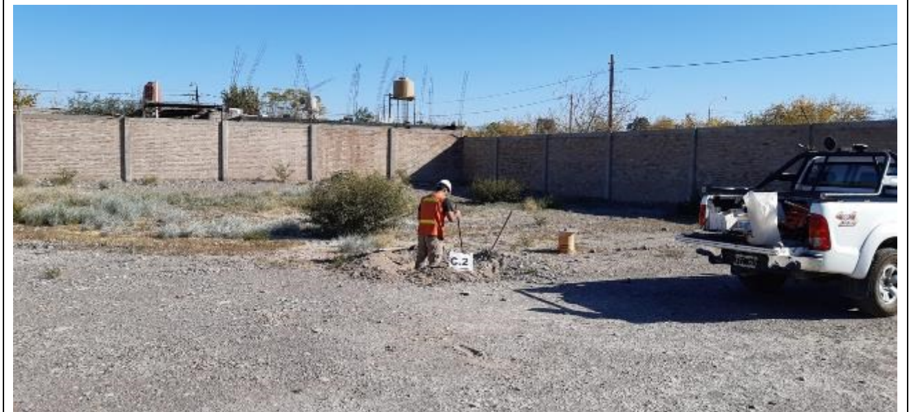
Fotografía N°11: Calicata C.2. Se muestra la posición de la calicata ejecutada en el terreno estudiado, se observan los trabajos de excavación y toma de muestra.
