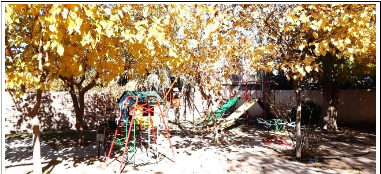
Fotografía N°12: Vista de la posición en el terreno del Sondeo S.2. Se observan los trabajos de perforación y toma de muestra, como así también el ensayo de penetración estándar (SPT).
