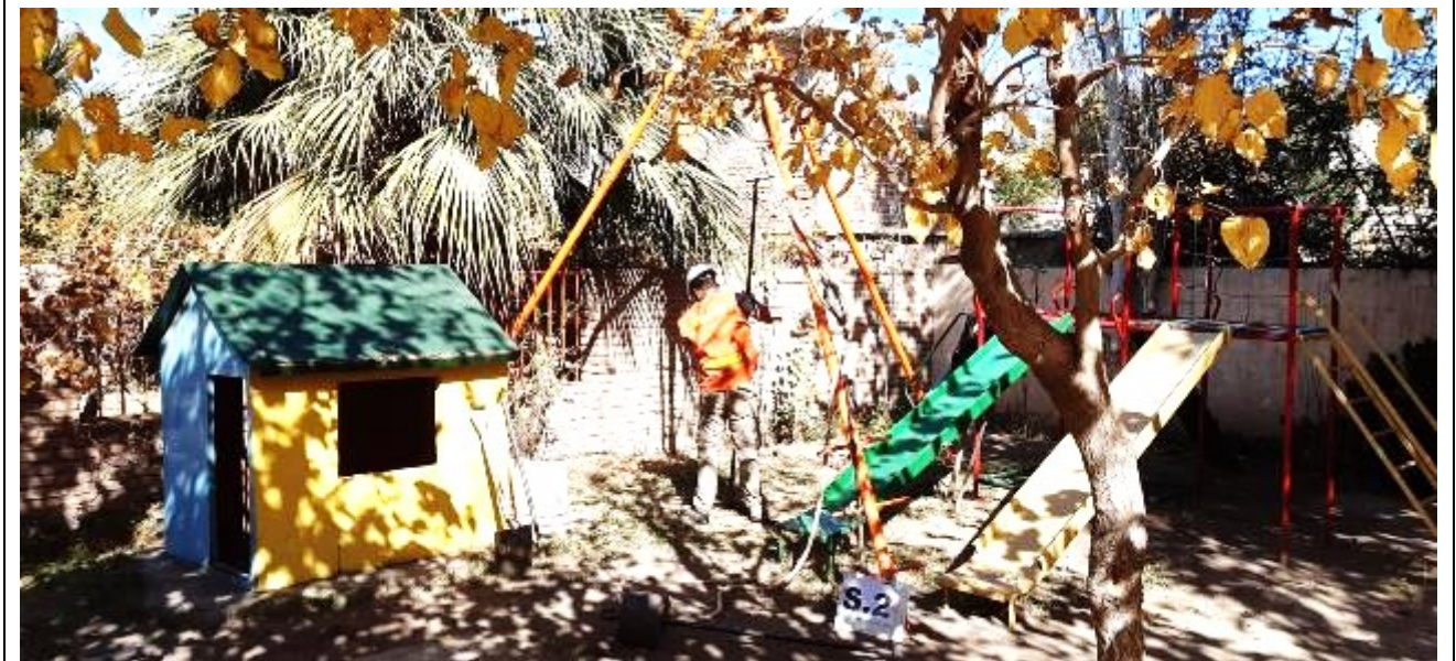
Fotografía N°11: Vista de la posición en el terreno del Sondeo S.2. Se observan los trabajos de perforación y toma de muestra, como así también el ensayo de penetración estándar (SPT).
