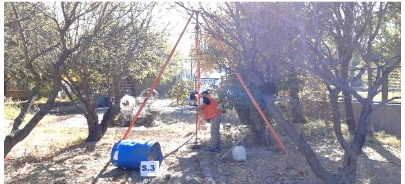
Fotografía N°15: Vista de la posición en el terreno del Sondeo S.3. Se observan los trabajos de perforación y toma de muestra, como así también el ensayo de penetración estándar (SPT).
