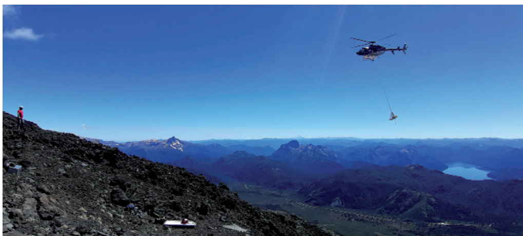
Apoyo de medios aéreos en la instalación
