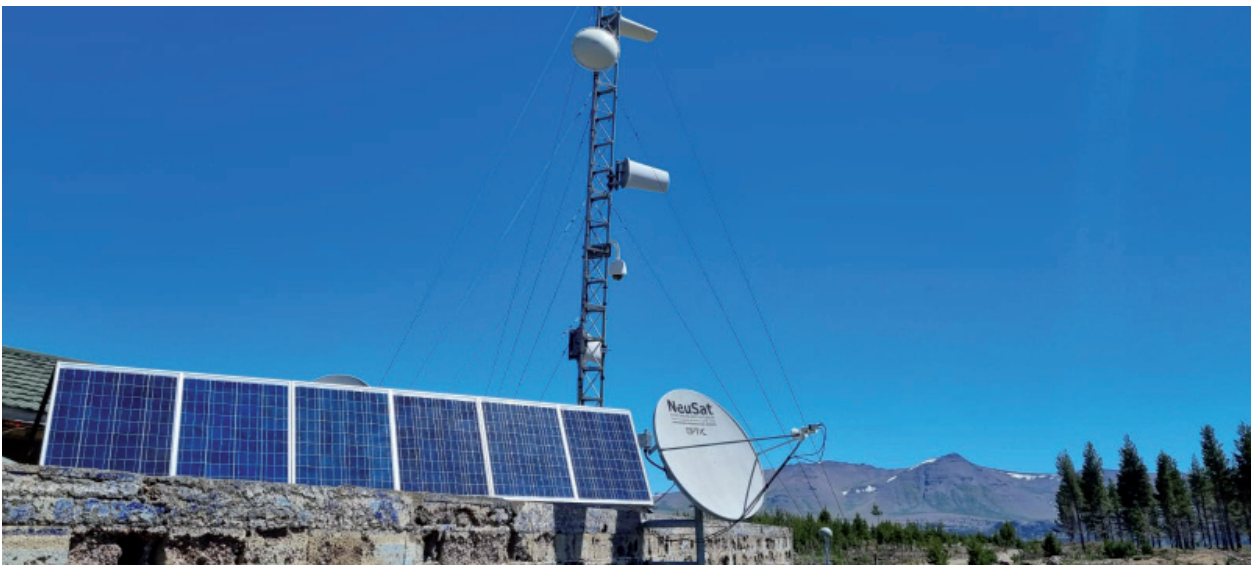
Fig 5: Nueva instalación de banco de paneles solares en el nodo satelital "Aeródromo" perteneciente a la red binacional de monitoreo del volcán Copahue, Provincia de Neuquén.
