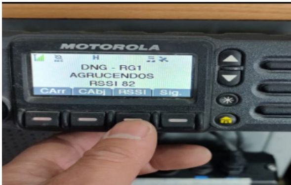
Instalación de antena y equipo base APX 7500.
