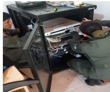
Integrantes de la División Sistemas Digitales y Video Operativo realizando instalación de Router GGM 8000 para vínculo Ethernet del Sitio de Consolas “Campo de Mayo”.
