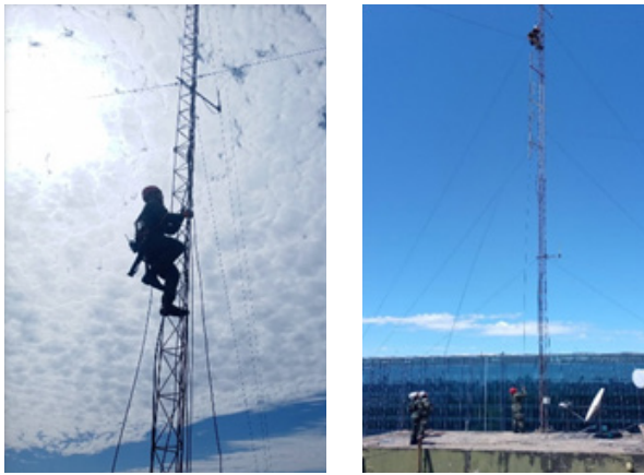
Despliegue y montaje de la ANTENA HF BANDA ANCHA y tareas de mantenimiento en antenas Ringo montadas en torre RH 16/8 de 24 mts.
