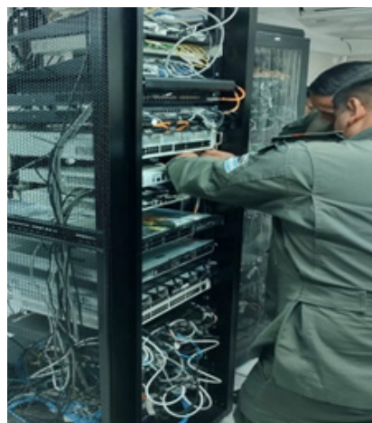
Implementación de equipos Firewalls en Sala de Servidores en el Edificio "CENTINELA".
