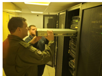
Instalación de Servidor VMS en "Master Site" Edificio "CENTINELA".
