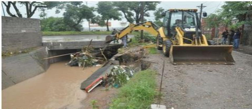
ANEGAMIENTOS | EN LA ÉPOCA ESTIVAL LOS VECINOS DEL CANAL ALVARADO SUFREN LAS CONSECUENCIAS DE SU MAL ESTADO.
