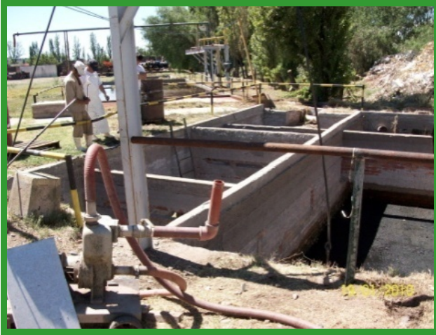
Foto 53: Planta de Tratamiento de Efluentes
