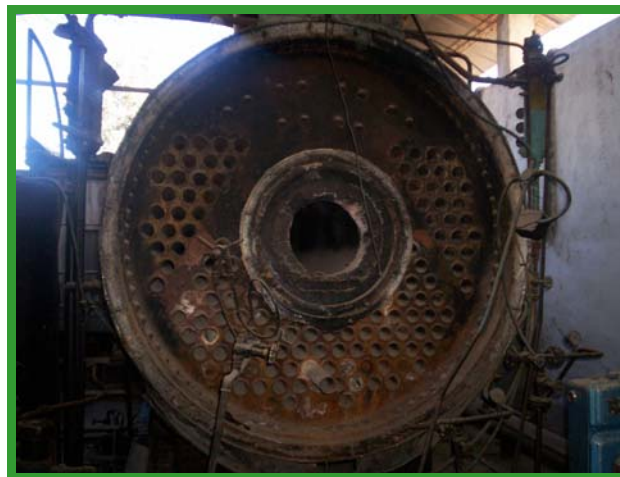
Foto 6: Deterioro Interno de Caldera
