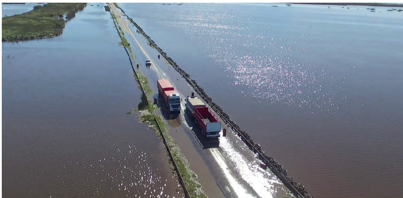
RN N° 8 a la altura de Arias, provincia de Córdoba durante las inundaciones de 2017
