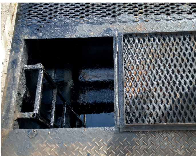
Ingreso a pileta de lodo
