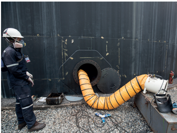
Equipo de ventilación en Espacio Confinado
