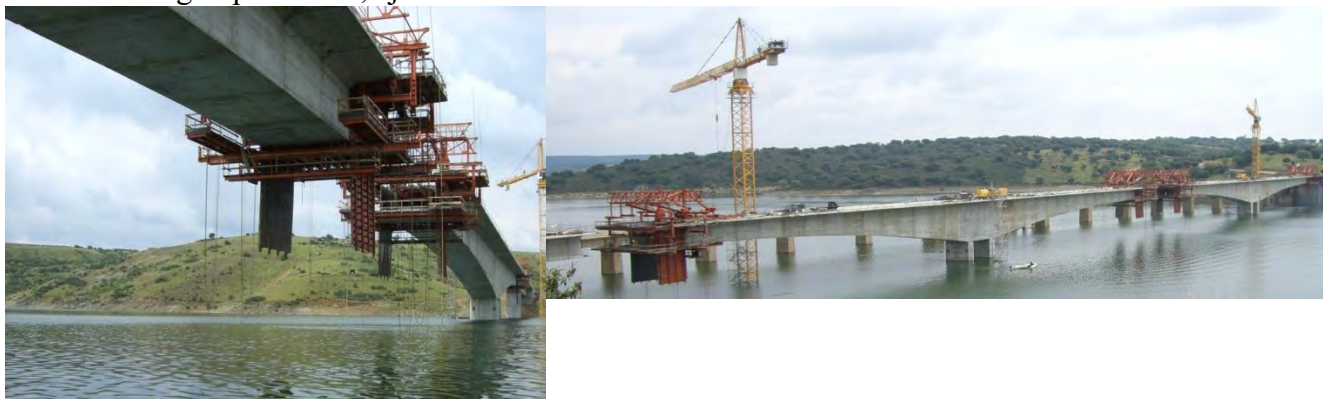
Foto 25. Puente de Manzanal del Barco, de 190 m de luz principal y sección con cajón de hormigón postesado, ejecutado mediante avance en voladizo.
