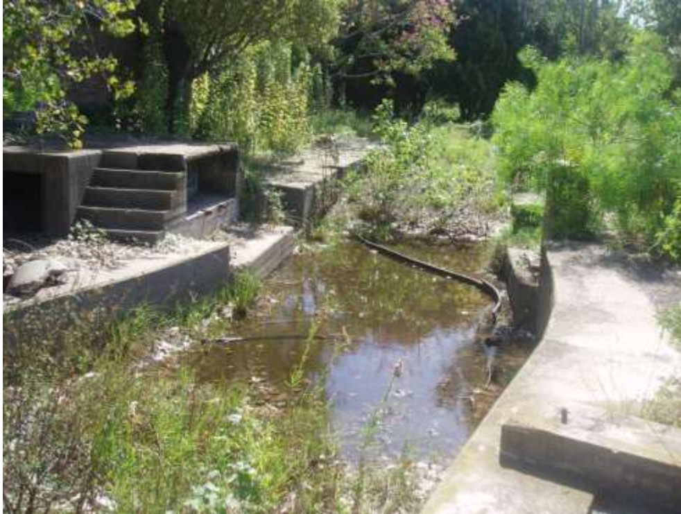
Foto 3-71. Sector con acumulación de agua en construcción abandonada.
