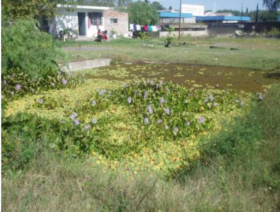
Foto 3-61. Pileta de cemento con acumulación de agua y desarrollo de vegetación.
