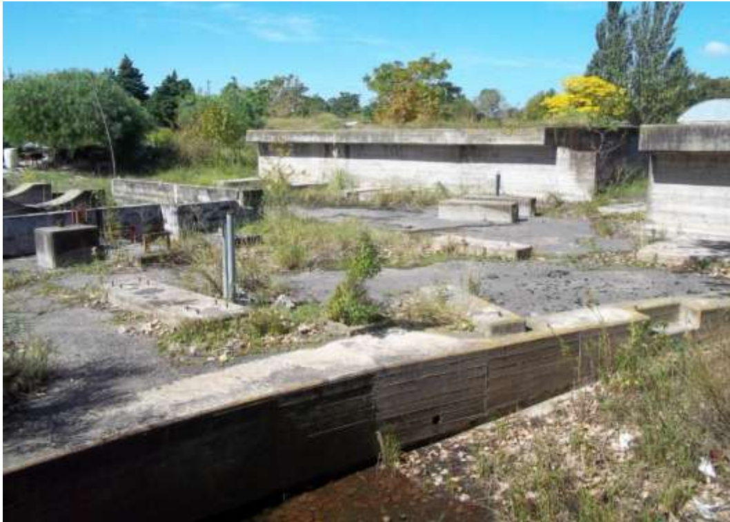
Foto 3-9. Infraestructura ferroviaria abandonada (fuera de la zona de implantación de la futura SET), vista al E.
