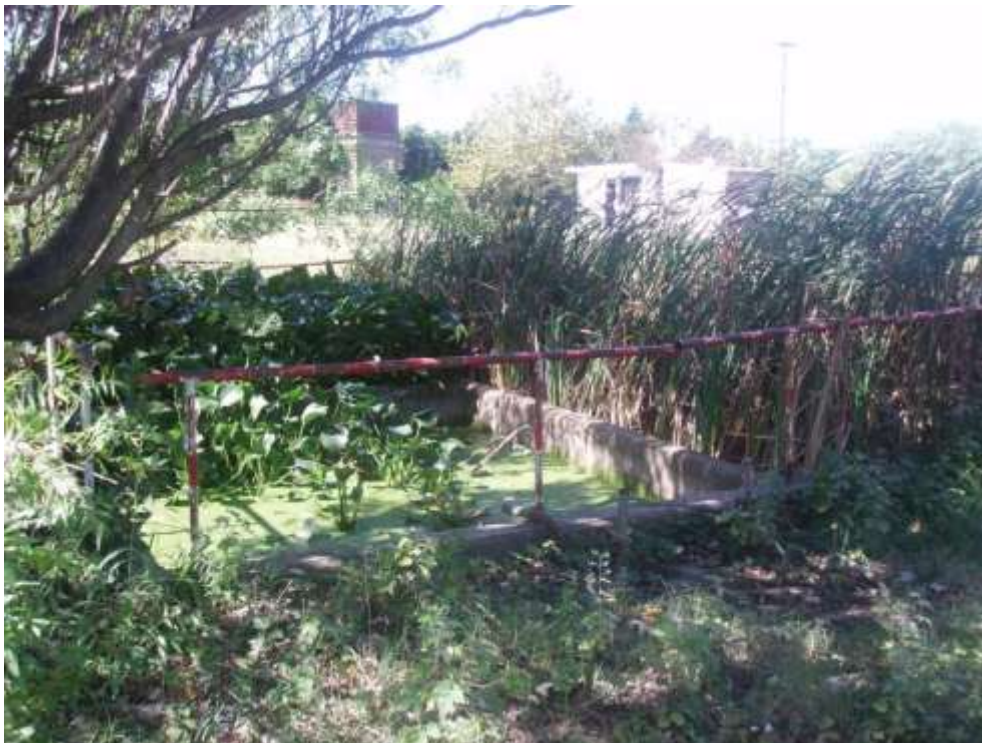
Foto 3-72. Pileta de cemento con acumulación de agua y desarrollo de vegetación.
