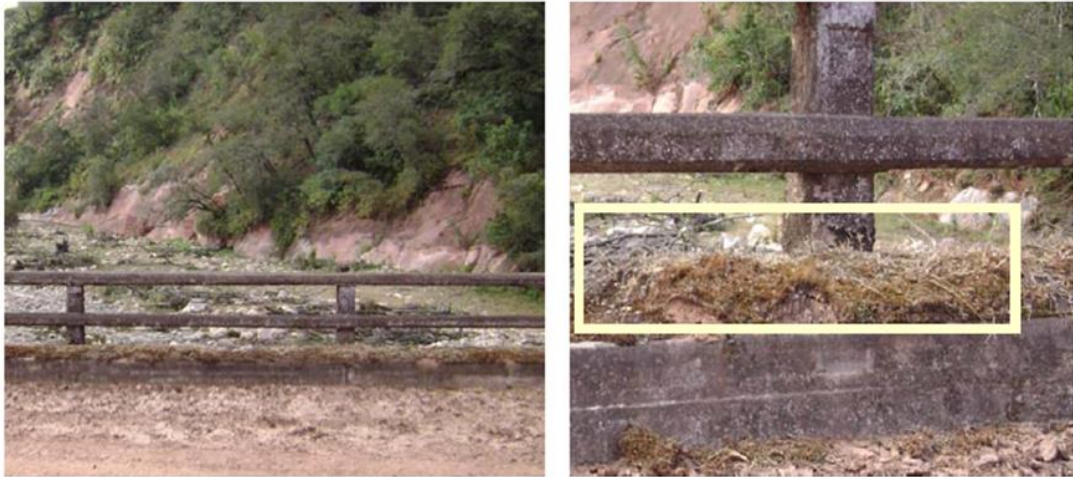
Foto 8: Material pelítico correspondiente a una colada de barro. Nótese que el flujo paso por arriba del puente (detalle de la derecha)
