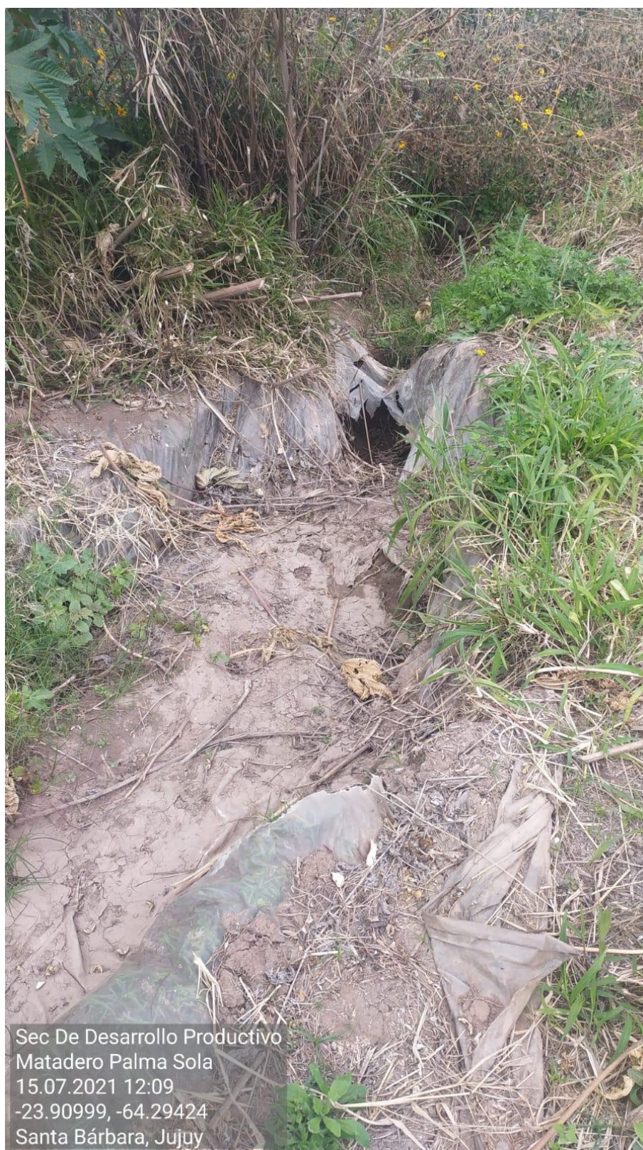
Foto 13: Canales de riego con impermeabilización precaria
