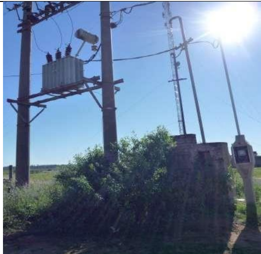
Estación transformadora de media tensión en el camino de acceso al predio. Abastece al mismo y a la zona.
