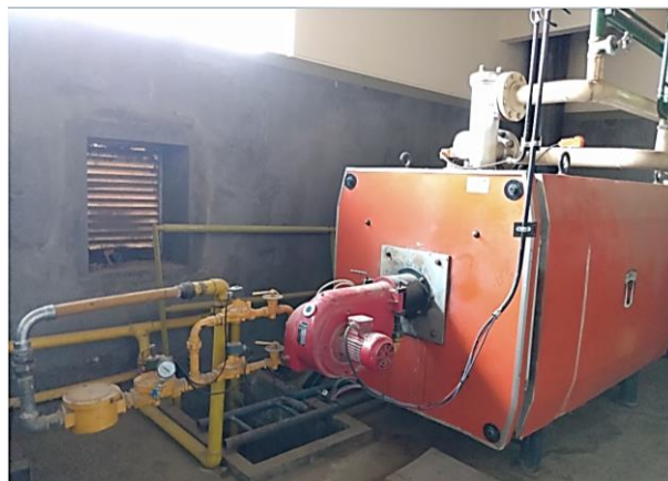
Caldera utilizada para la calefacción del Edificio Esparza
