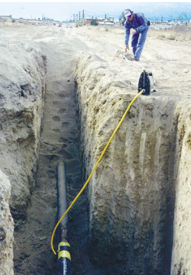
Gammagrafía de una tubería
