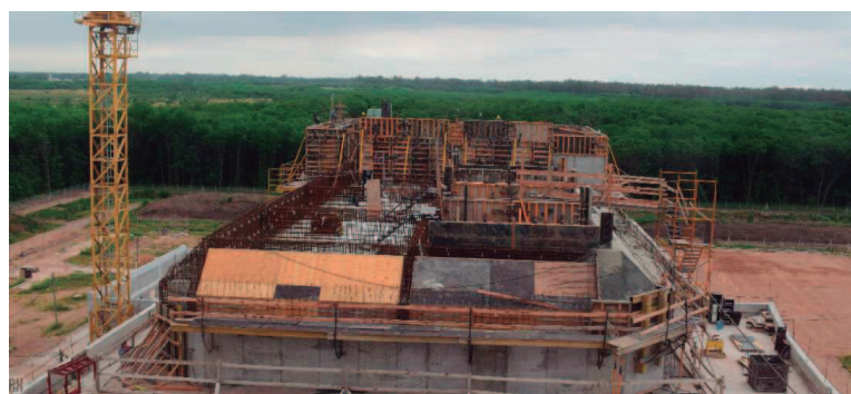
Reactor Multipropósito RA-10 en construcción en el Centro Atómico Ezeiza (Crédito CNEA, diciembre 2021)
