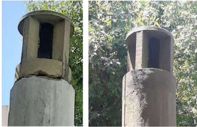
Columna de ventilación Cámara de Acceso N°27
