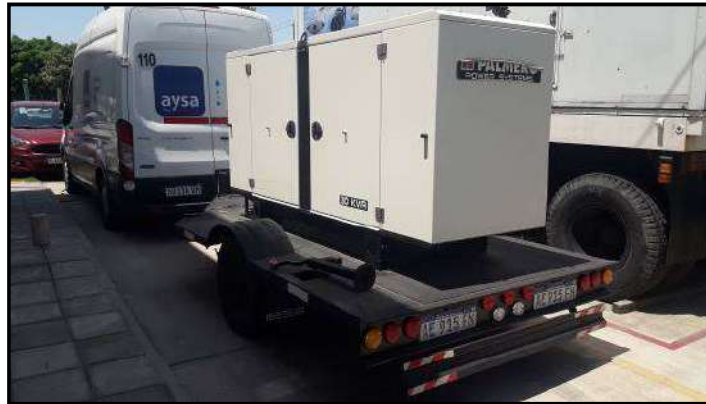
Grupo electrógeno 30 kVA
