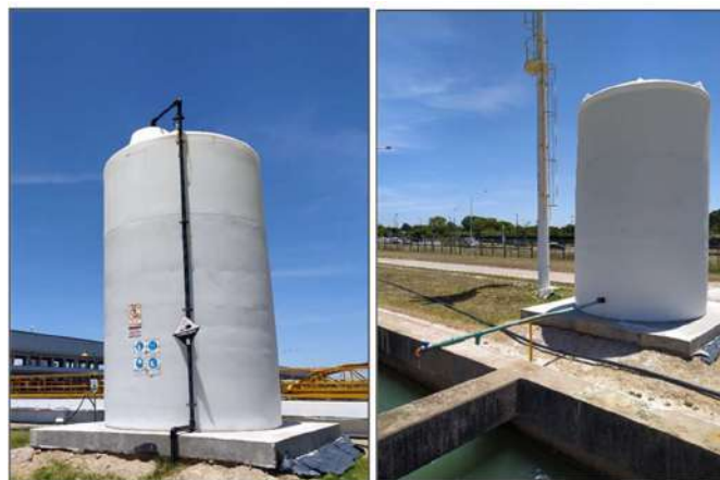
Tanques de almacenamiento de hipoclorito de sodio
