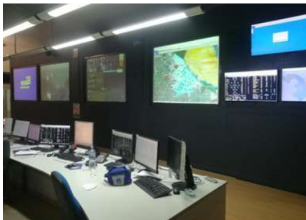
Control Centralizado de Agua - Sala de Control
