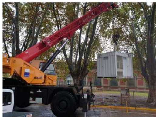
Emplazamiento estructuras contenedoras SMCC AMBA
