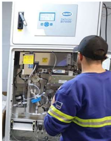
Mantenimiento SMCC complejo
