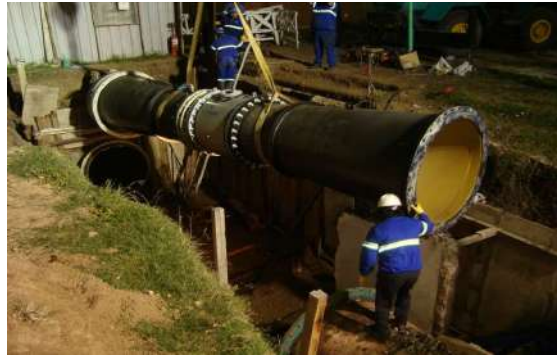
Foto 1: Medidor EM de Carretel
