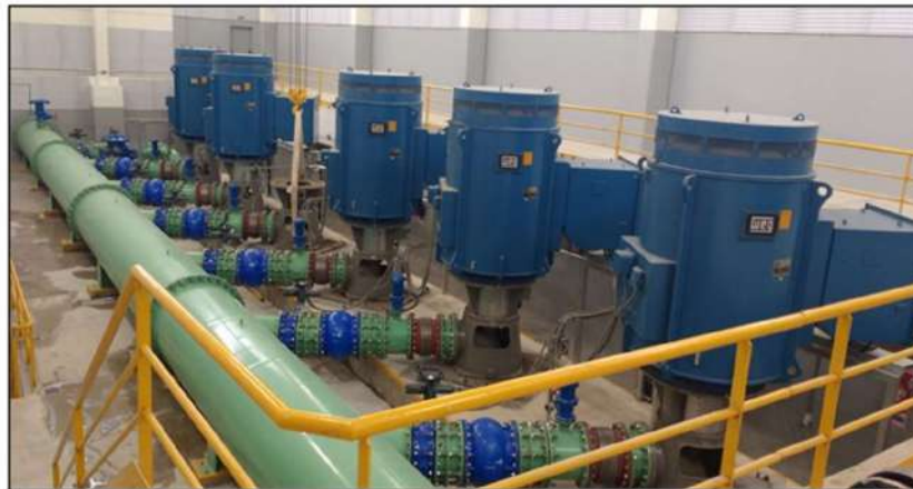
Estación Elevadora Bernal IV
