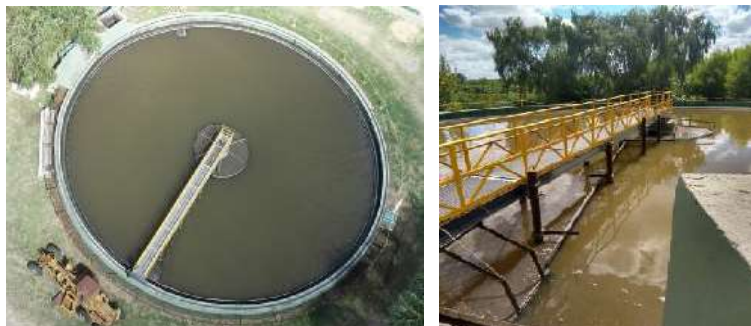
Sistema de extracción de Lodos
