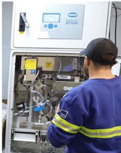
Mantenimiento SMCC complejo
