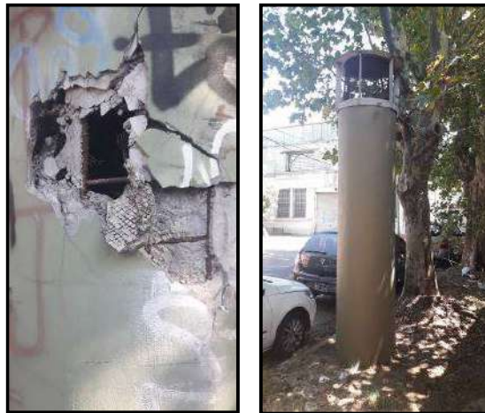
Columna de ventilación Cámara Nueva
