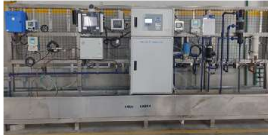
SMCC Agua Cruda PJMR
