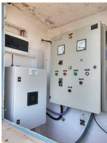
Imagen 3: Tablero de medición instalado
