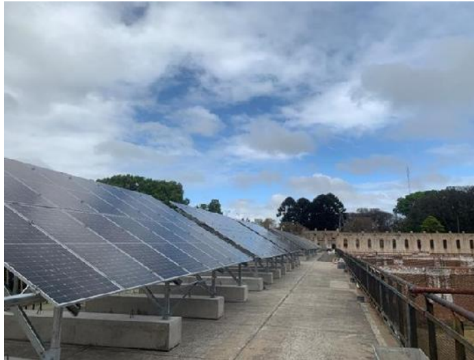
Imagen 6: Paneles solares ubicados en PSM
