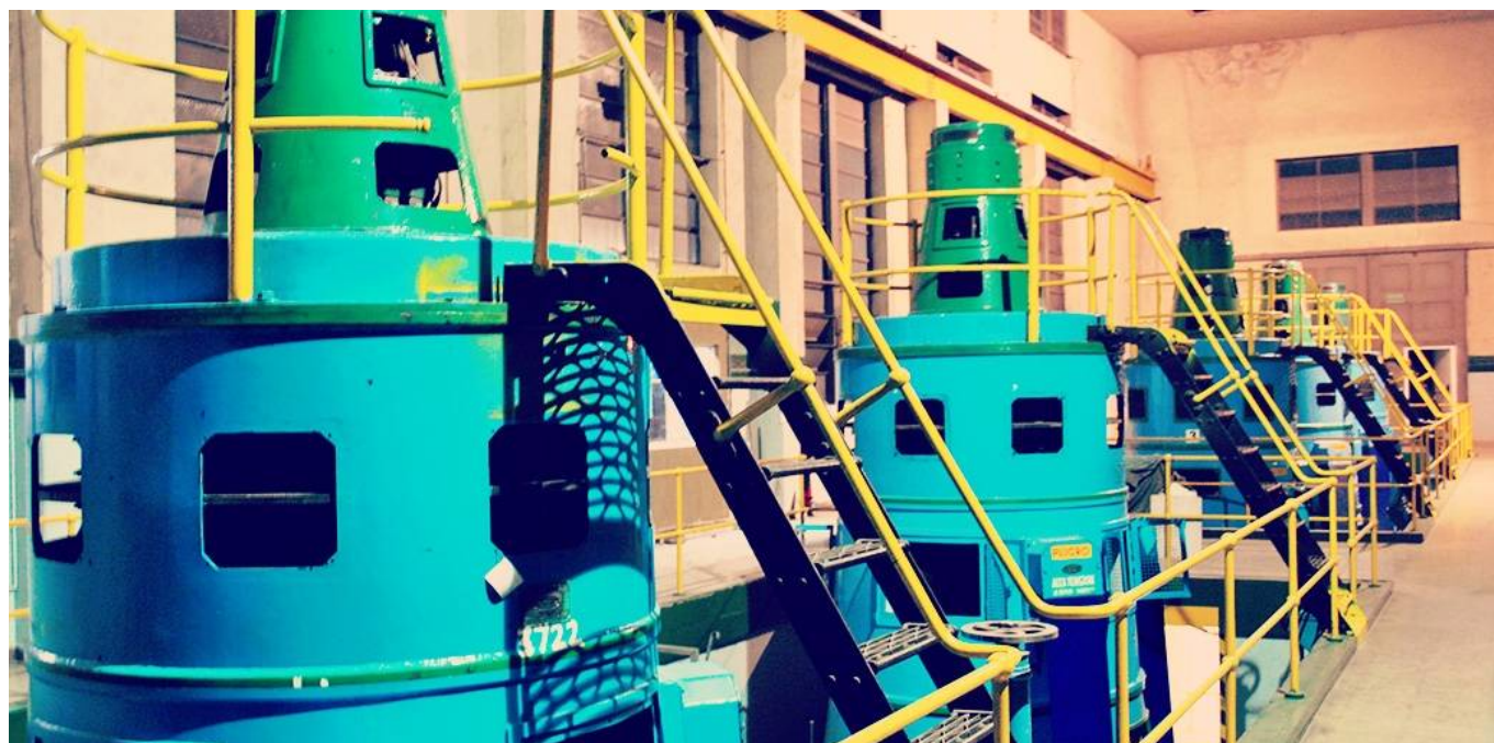
Imagen 9: Foto sala de Bombas Estación Elevadoras
