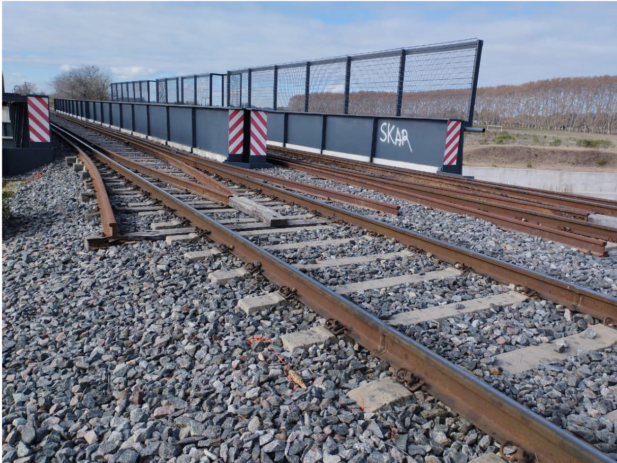
Figura 15 Conjunto rieles, fijaciones, durmientes de hormigón, durmientes de madera, balasto y encarriladores. Fuente: JST
