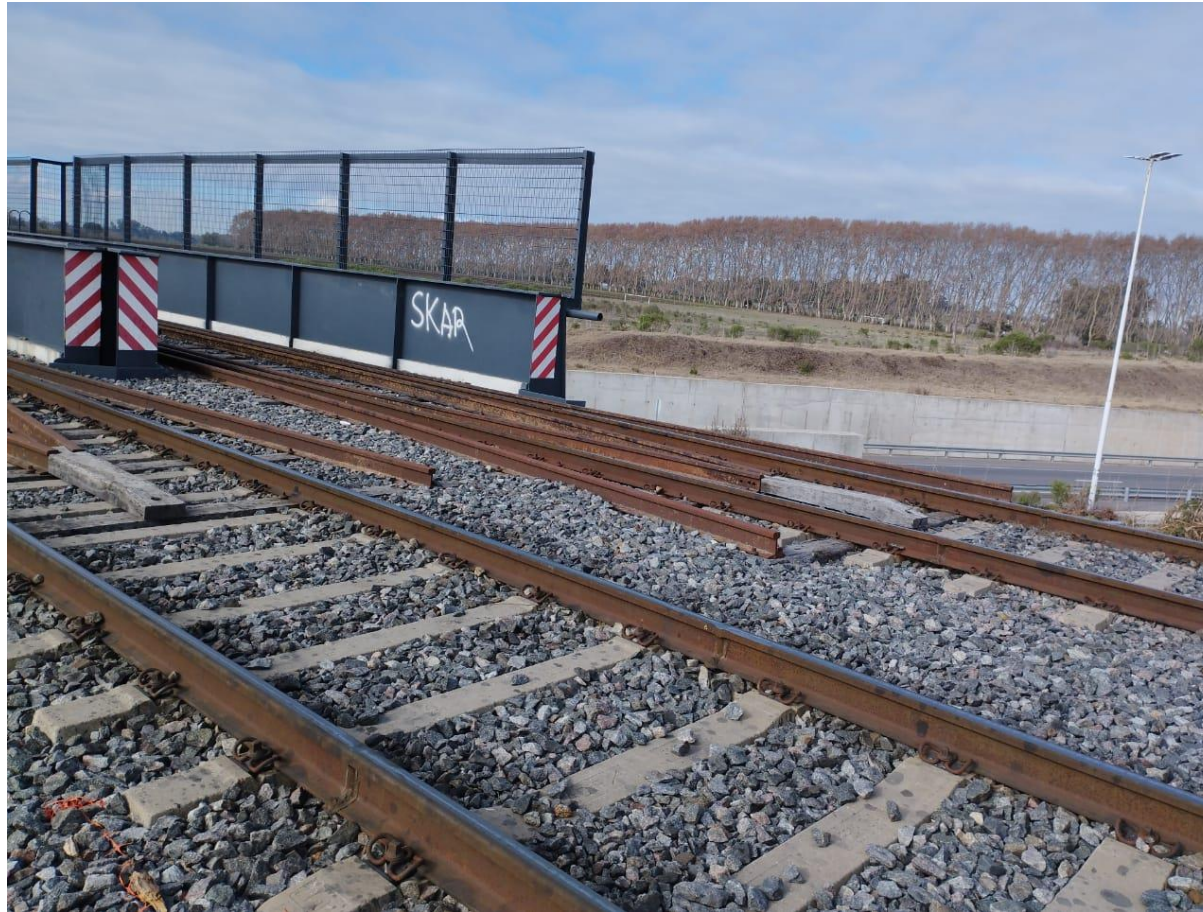
Figura 12 Conjunto rieles, durmientes de hormigón, balasto y encarriladores. Fuente: JST
