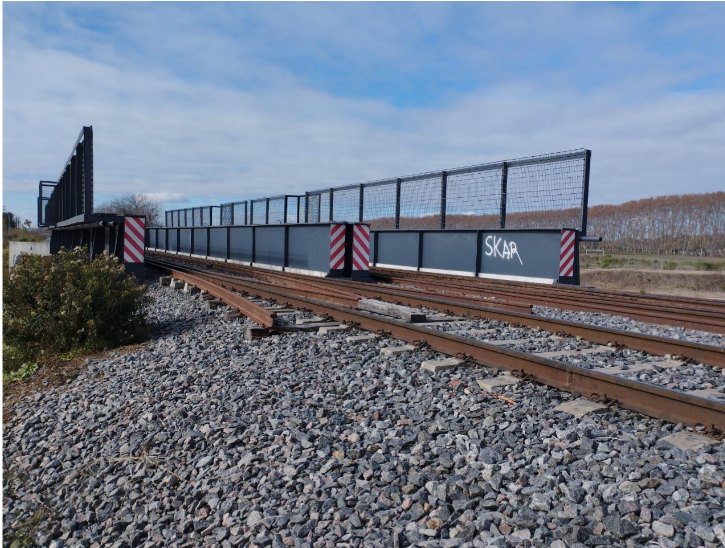
Figura 50 Conjunto rieles, durmientes de hormigón, balasto y encarriladores. Fuente: JST
