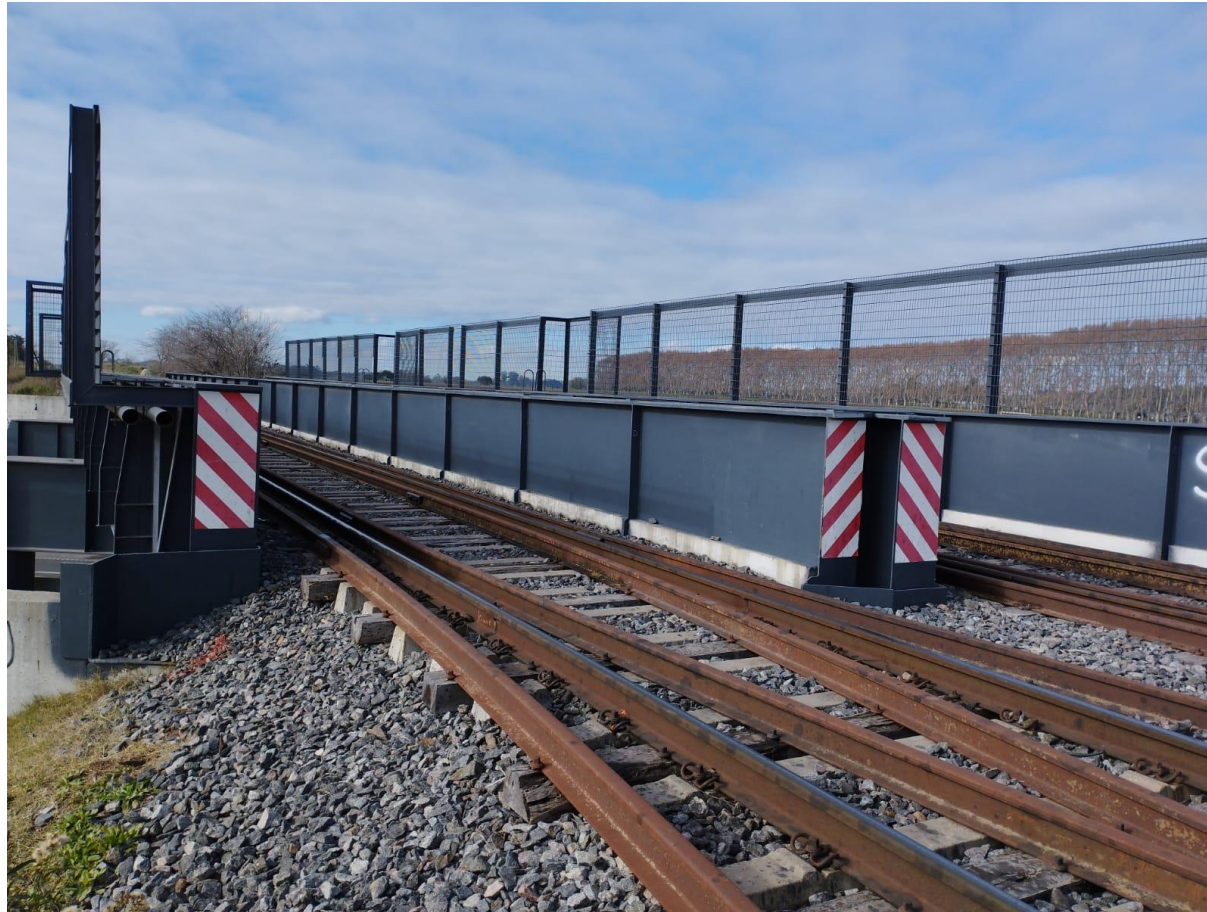
Figura 11 Conjunto rieles, durmientes hormigón, balasto y encarriladores. Fuente: JST
