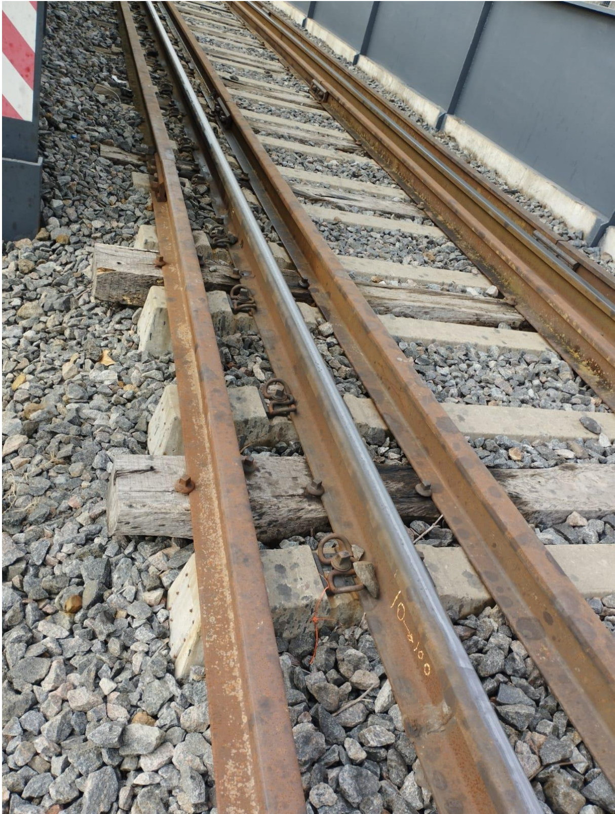
Figura 14 Conjunto rieles, fijaciones, durmientes de hormigón, durmientes de madera, balasto y encarriladores. Fuente: JST
