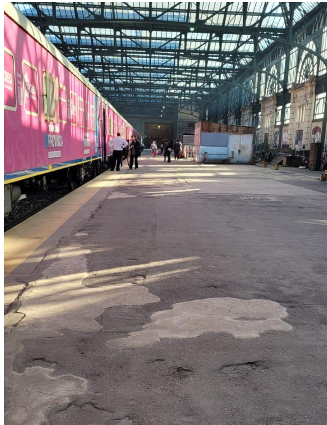
Figura 6. Irregularidades en el andén 14 de la estación Constitución. Fuente: JST, 2023
