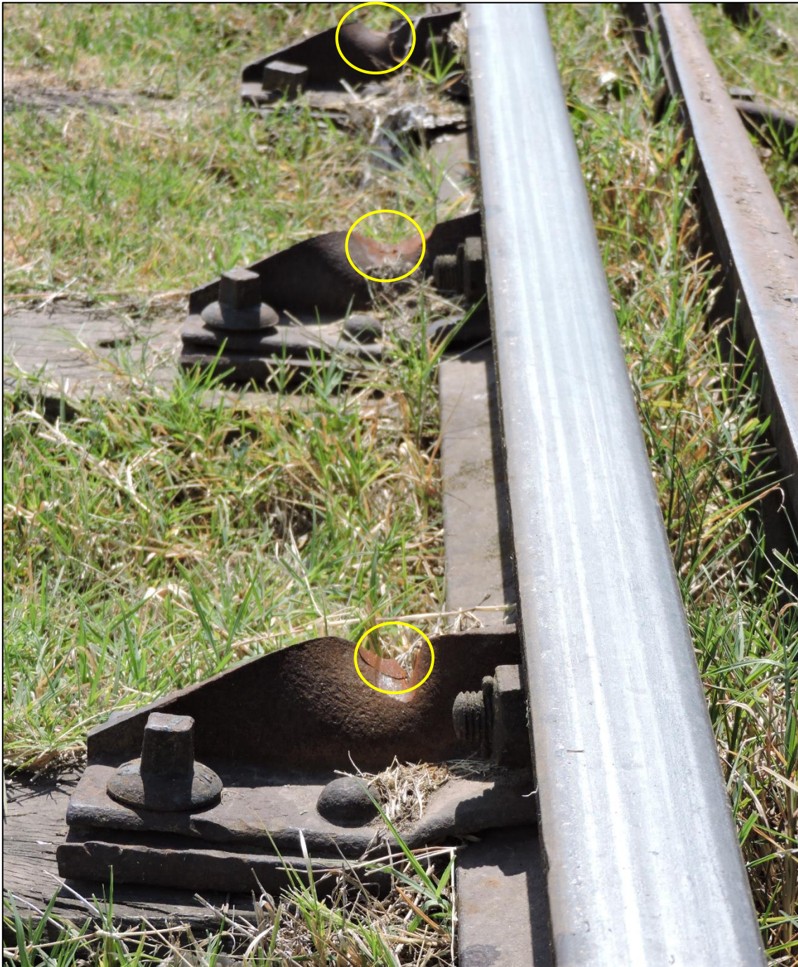
Figura 20. Marcas de las pestañas en las fijaciones del ADV, causadas por un descarrilamiento.
