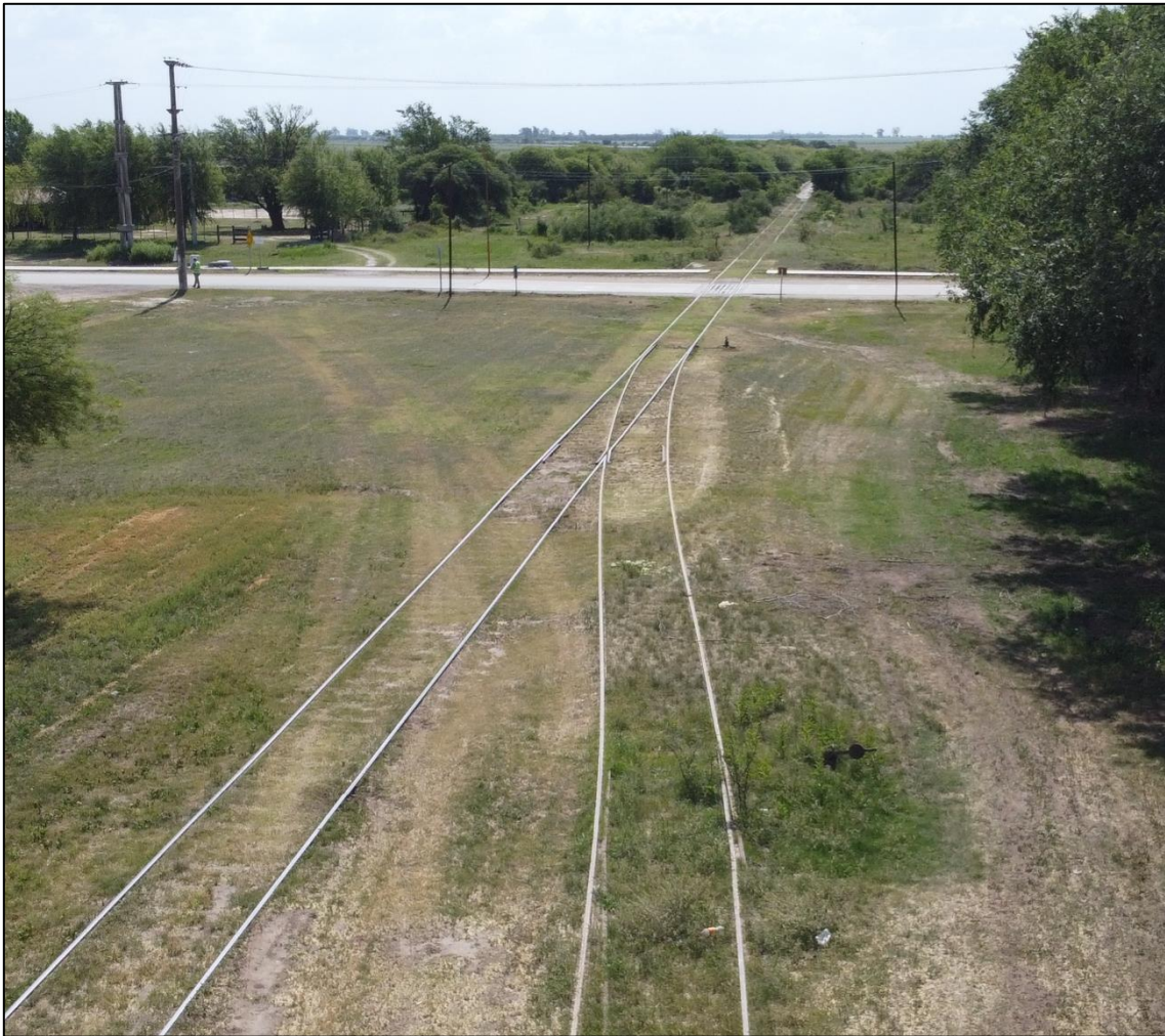
Figura 19. Vista general del ADV. Fuente: JST, 2023
