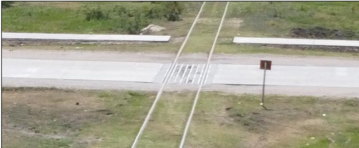
Figura 8. Ausencia señales H1 y H4. Fuente: JST, 2024
