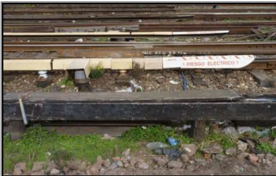
Foto 4. Tramo con aislador de soporte, acometida de cables desde subestación y rampa
