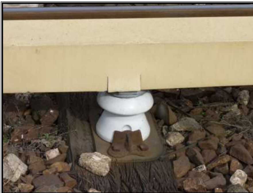
Foto 6. Aislador soporte instalado en durmiente de madera
