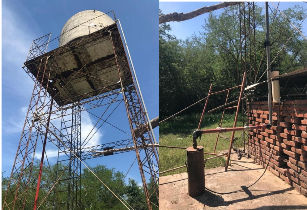
1 Tanque y bomba de agua de la Comunidad guaraní
