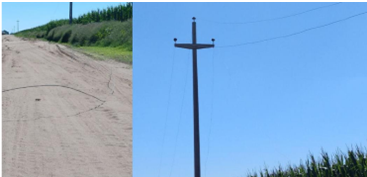
Figura 3. Daños del tendido eléctrico.
