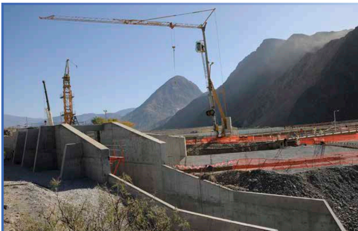
Central Hidroeléctrica Punta Negra
